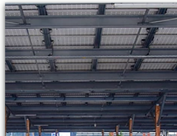
Sous-face d'une ombrière Panneaux monocristallins
